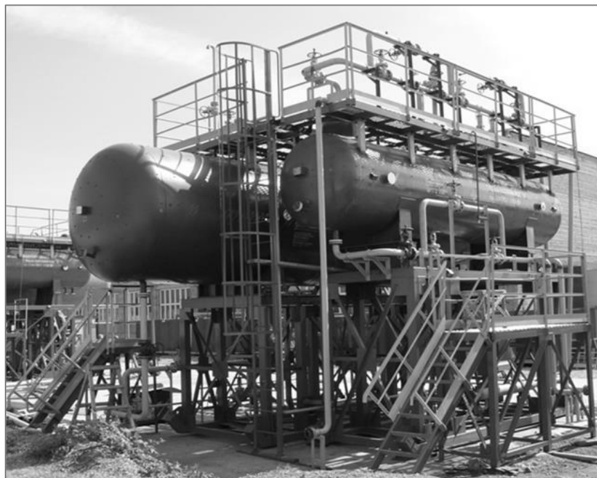
Рисунок 1.1 – Сепараторы на установке подготовки нефти
